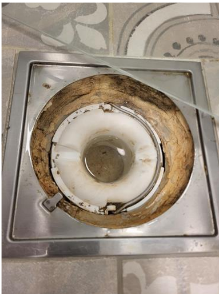
Våtrom - [Sluk på bad 1]
