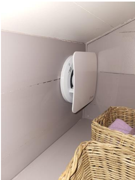
Toalettrom (Ikke våtrom) - [Avtrekksvifte toalett]
