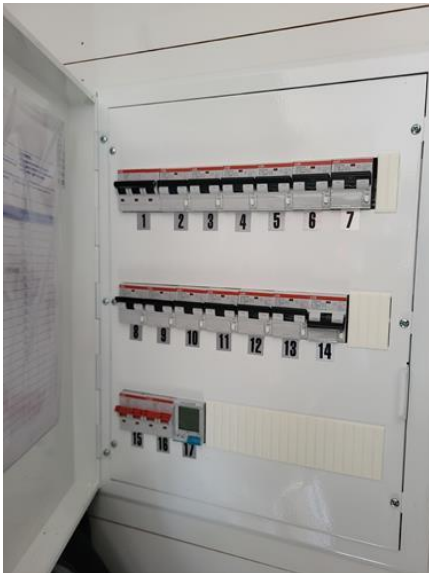
Elektrisk anlegg - [Sikringskap i bod]
