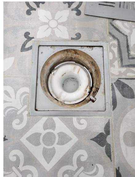
Våtrom - [Sluk på bad 2]
