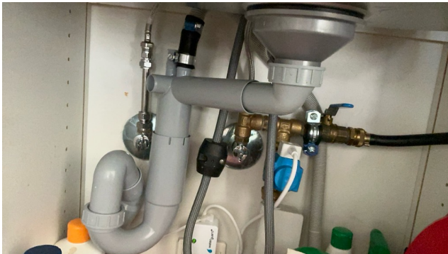
Avløp vask kjøkken
