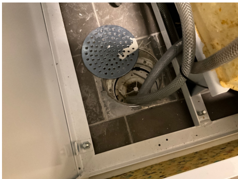
Sluk under ventilasjon
