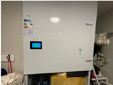
Ventilasjon, eier bytter filter selv.
