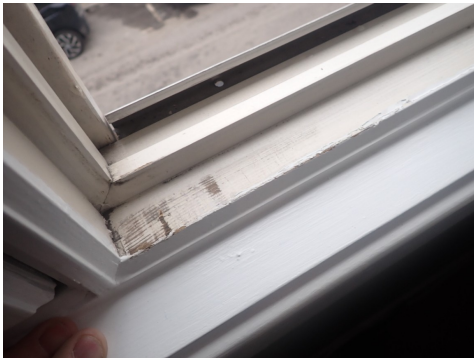
Slitasje på karmen på enkelte vinduer.
