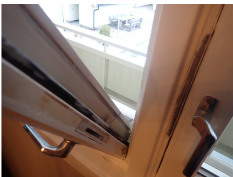
Det er defekt åpne/lukkefunksjon på vinduet på soverommet
