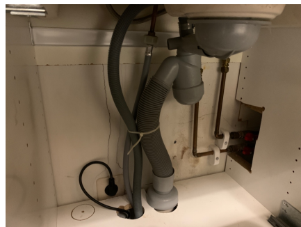
Rørapplegget i kjøkkenet
