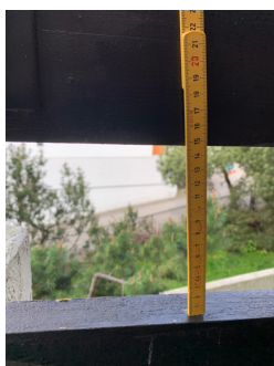
For stort mellomrom mellom liggende bord
