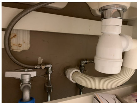
Røropplegget i servantskapet
