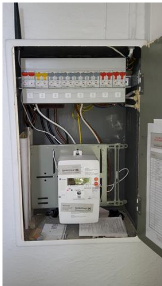
Elektrisk anlegg - [Sikringsskap]
