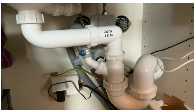
Avløp vask kjøkken
