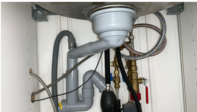
Avløp vask kjøkken
