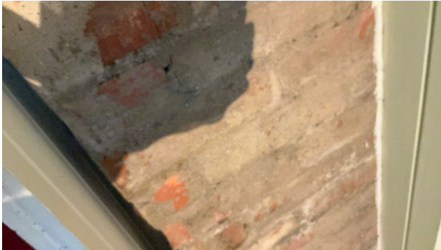
Brennbar plate ved pipeløp loft.
