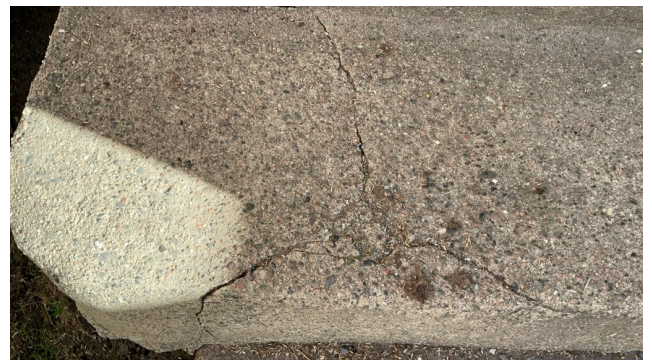
Sprekk i trinn.
