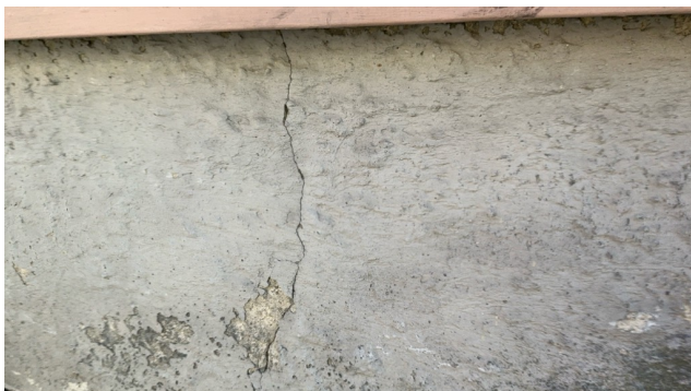
Riss/sprekk i overflater grunnmur
