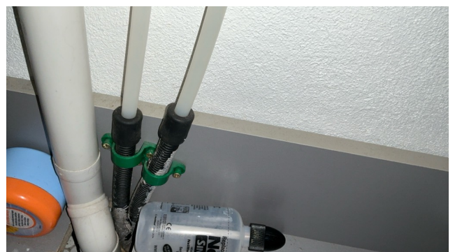
Vannrør servant bad.
