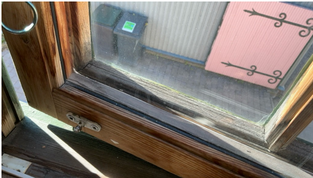
Synlig mangelfullt vedlikehold ramme og karm
