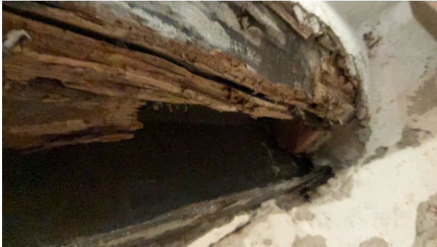
Bjelke med råte og skader.
