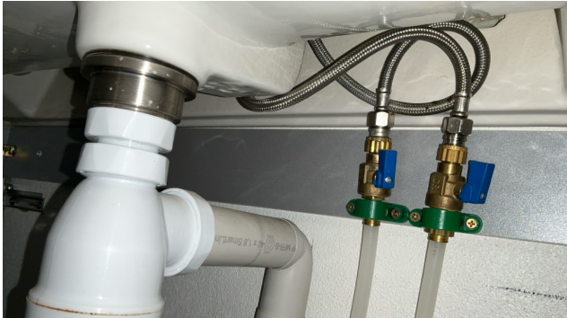
Avløp servant bad
