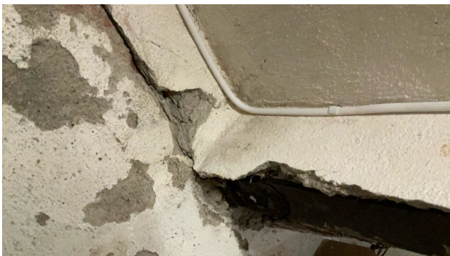
Skader i mur/betong
