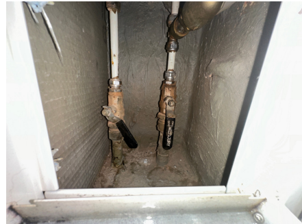
Stoppekraner plassert på bad
