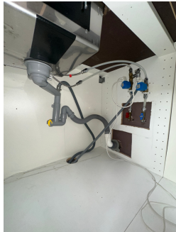
Rørøpplagg i kjøkkenbenk med Waterguard
