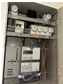
Sikringsskap plassert i felles oppgang.
