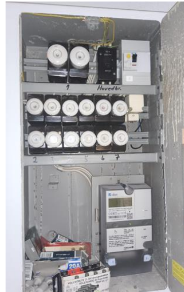
Elektrisk anlegg - [Sikringsskap ]
