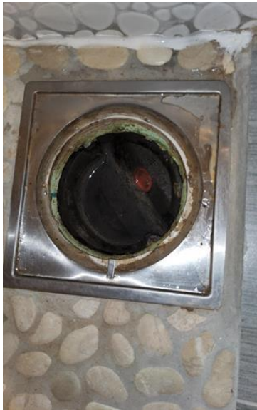
Avløpsrør (ink. sluk) - [Sluk på bad]
