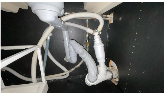
Røropplegg på kjøkken.
