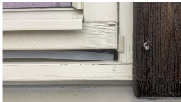
Løs tetteliste og vedlikeholds behov.
