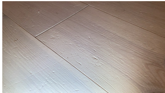
Slitasje / hakk i gulvflater.
