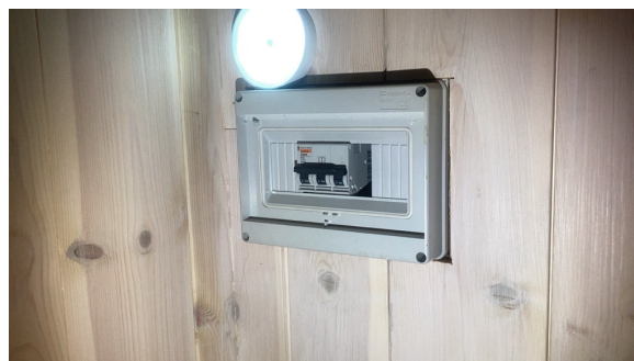
Sikring inne i hytta.
