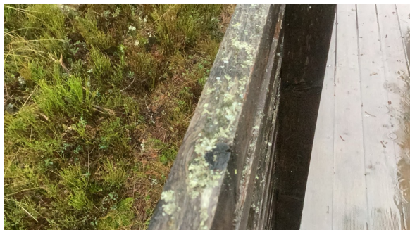
Mose på rekkverk.
