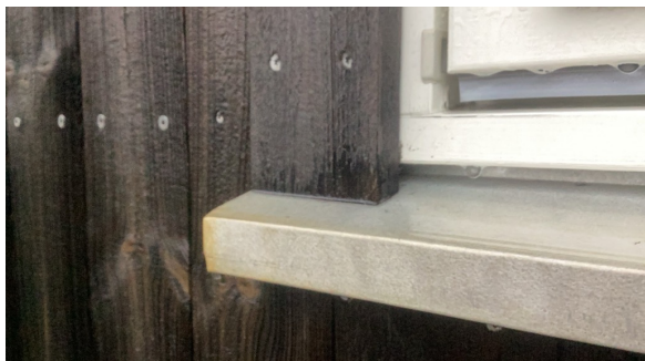
Lav klaring mellom omramming og vannbrett.
