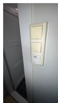
Termostadbryter for varmekabler.
