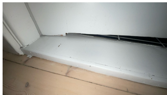
Luftespalte under dørbladet.
