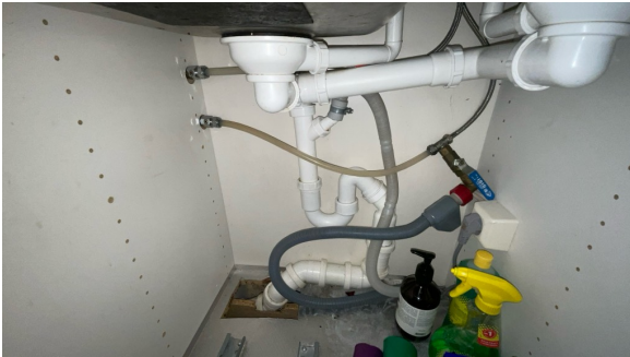
Rør på kjøkken.
