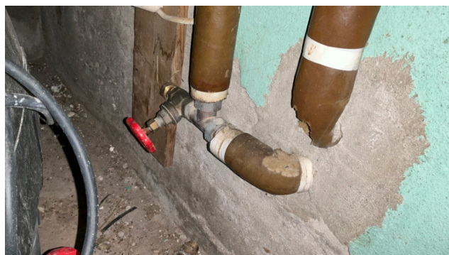
Vannrør og opprinnelig stoppekran i kryperom. Ikke i bruk
