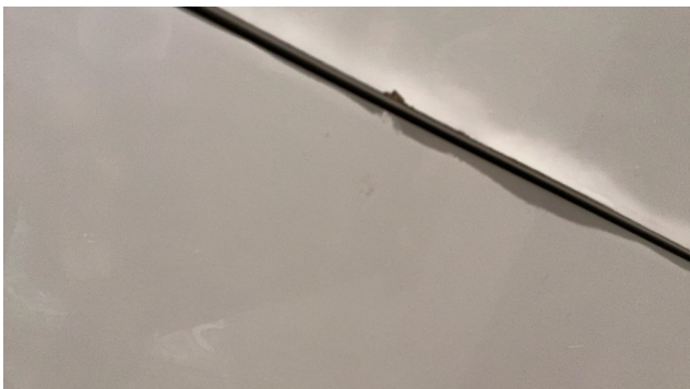
Antydning svell front servantskap
