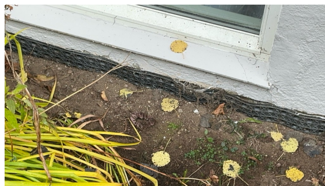
Synlig knasteplast langs grunnmur
