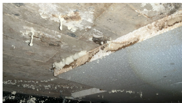
Tak krypkjeller. Synlig rester av fugeskum
