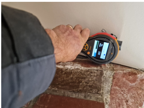
Fuktsøk med Protimeter MMS i området rundt gjennomføring pipeløp
