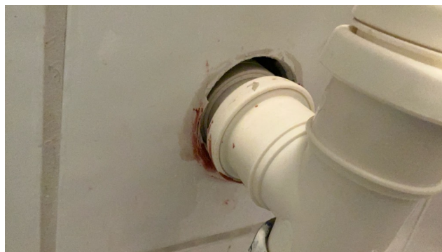
Utett gjennomføring avløp fra kjøkken til bad
