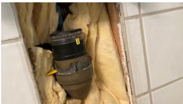
Hovedstoppekran bak luke i vegg bad
