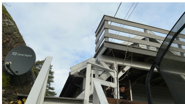
Det mangler rekkverk på deler av trapp og samt helt oppe ved veranda
