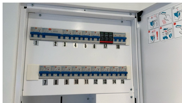
Sikringskap 1. etasje Med hovedsikring
