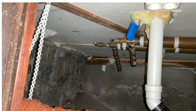
Gjennomføring gjennom tak. Merk denne gikk opp til opprinnelig kjøkken. Ikke mer i bruk.
