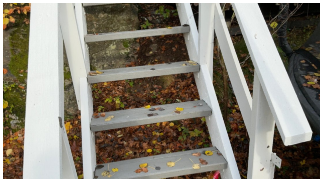
Store åpninger mellom trinn
