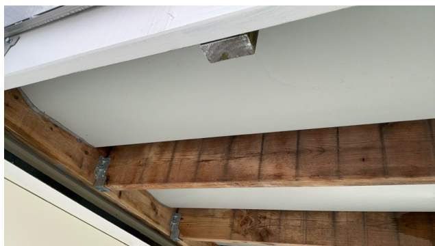
Avrenning overvann underside veranda. Renneplater som fører overvann til yttekant veranda
