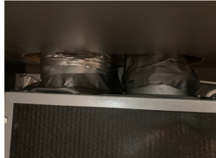
Rør bør tapes bedre for å sikre seg mot luftlekkasjer
