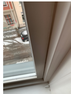
Vinduet er noe skjevt mot karm og kniper mot karm
