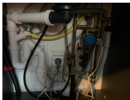
Røropplegget i kjøkken
