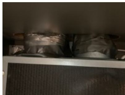
Rør bør tapes bedre for å sikre seg mot luftlekkasjer
