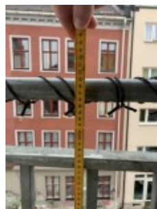
Noe lavt gelender iht dagens krav til høyde
