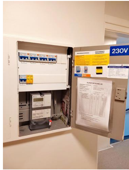
Elektrisk anlegg - [Sikringskap H401 Kristian Bakkens veg 12C]
