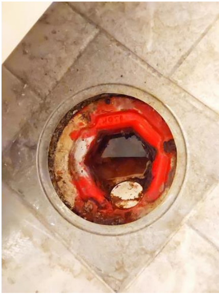
Våtrom - [Sluk Bad H401 Kristian Bakkens veg 12C]
