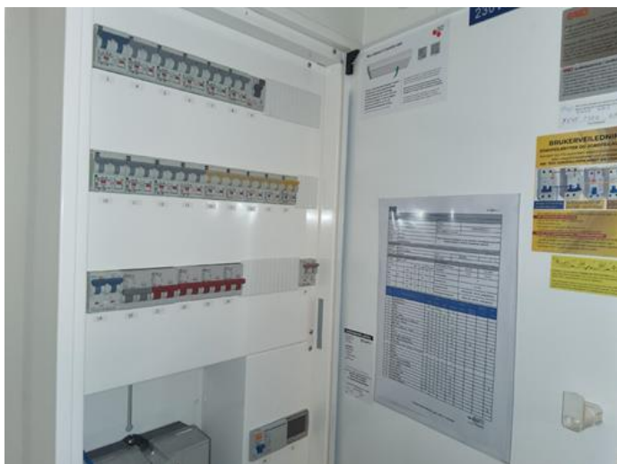
Beskrivelse - [Sikringsskap med kursfortegnelse. ]
