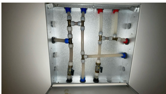
Fordelerskap på bad.
