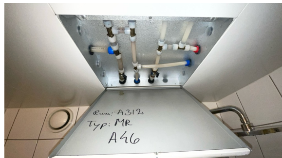
Fordelerskap på bad.
