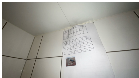
Test med løst ark viste tilfredstillende avtrekk.
