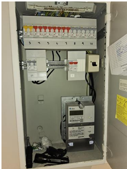
Elektrisk anlegg - [Sikringsskap]
