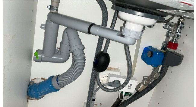
Avløp vask kjøkken
