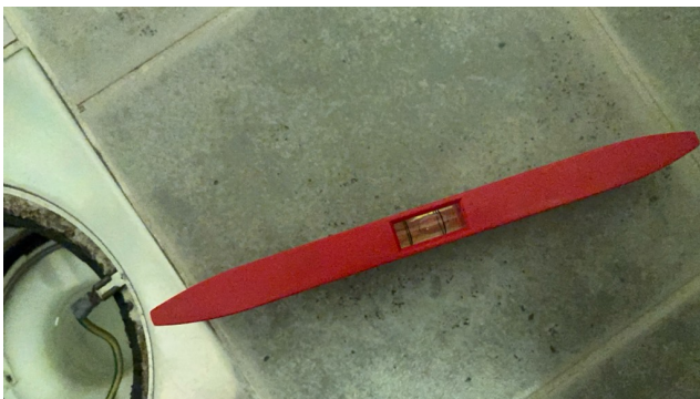
Fall mot sluk
