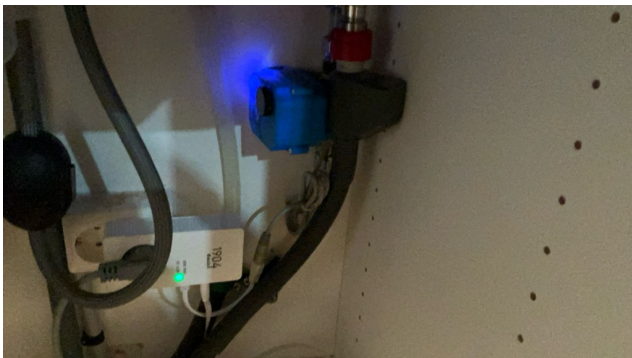
Automatisk vannstoppersystem i kjøkkenskap
