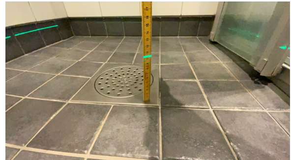
Høydeforskjell (ved sluk)
