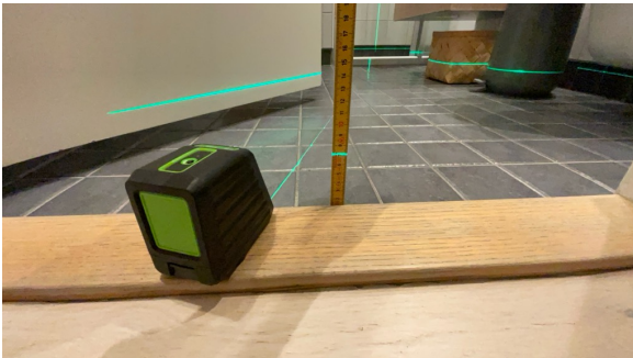
Høydeforskjell (flis ved terskel)
