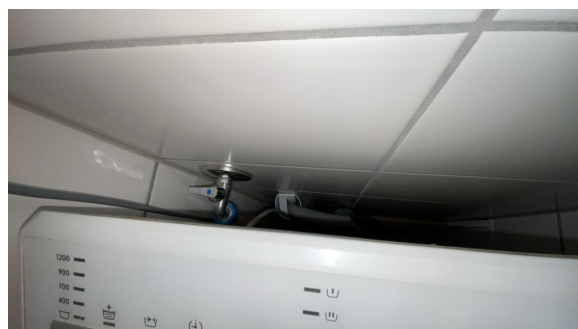
Opplegg til vaskemaskin. Avløpsrøret må renses.
