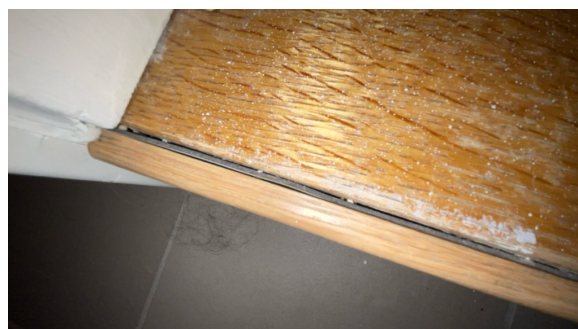
Synlig dukmembran ved dørterskel.
