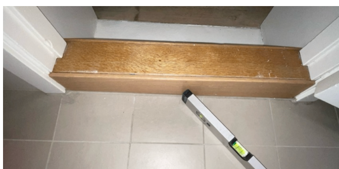
Høy dørterskel med membran bak.
