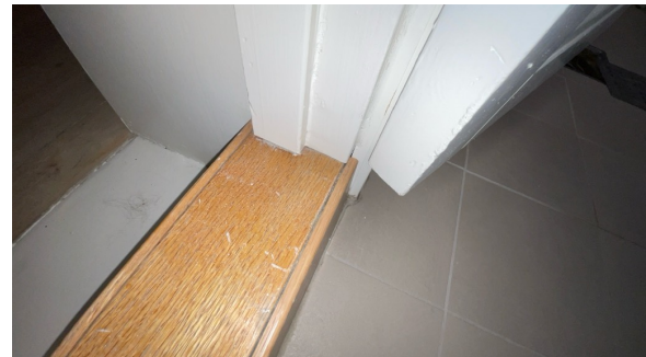
Luftespalte under dørbildet.
