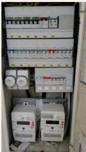
Elektrisk anlegg - [Sikringsskap]
