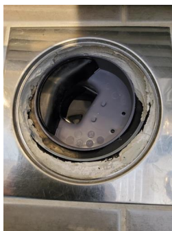
Tettesjiktets tilslutning til sluk - Sluk vaskerom.
