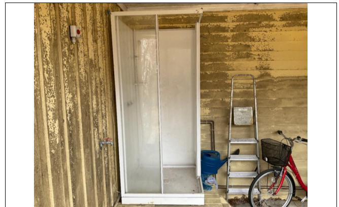
Soppvekst på kledning.
