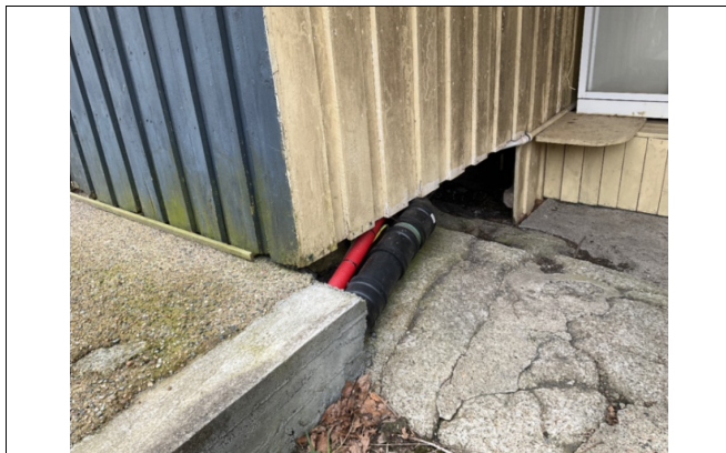
Avløp ligger åpent oppe i dagen. Utsatt for frostskafer.
