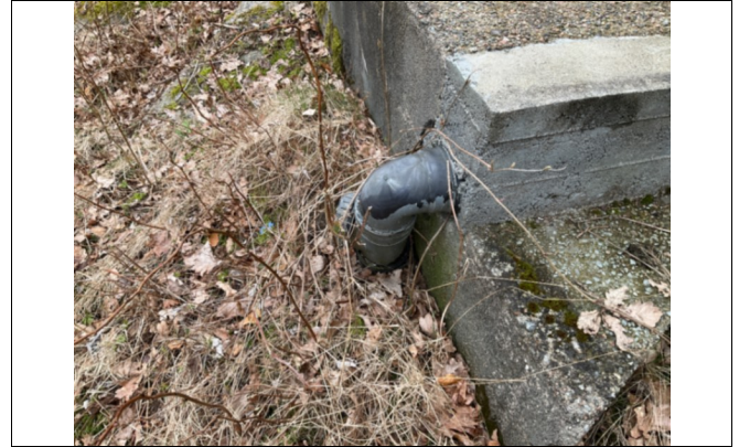
Avløp ligger åpent oppe i dagen. Utsatt for frostskafer.
