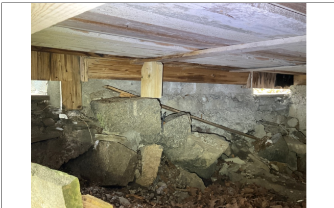
Ikke tilfredsstillende understøttet bæring.
