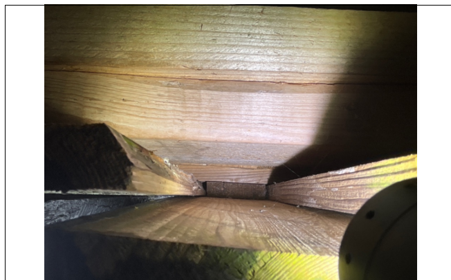
Ingen lufting bak kledning.
