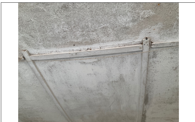
Soppvekst i tak. Luke til loft fysisk stengt. Ikke kontrollert. Kan være en risikokonstruksjon.
