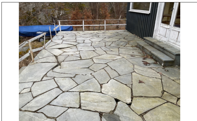
Løse skiferstein på terrasse.
