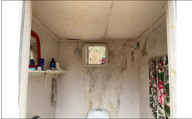
Soppvekst på vegg og tak på WC.
