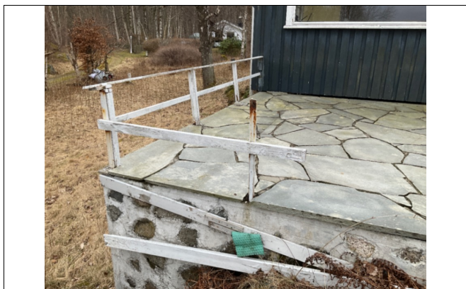
Defekt gjerde på terrasse.
