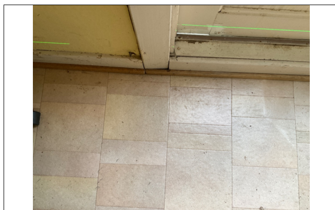
Svikt i gulv til venstre for terrassedør
