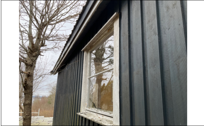
Det angler takrenner på en side av taket
