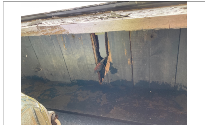
Synlig papp under takteking fra hul i bordtak
