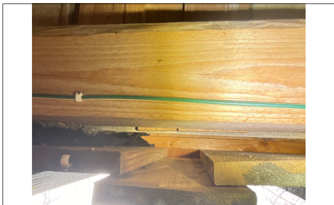
Ingen lufting bak kledning.
