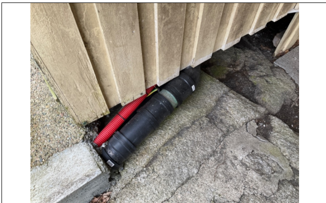
Avløpsrør og vannrør ligger oppe i dagen. Utsatt for frost på vinterstid.
