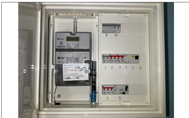
Sikringskap med automatsikringer.
