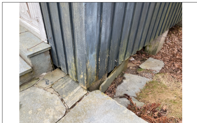
Råteskade på kledning
