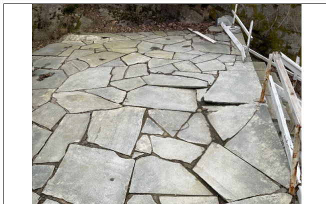
Løse skiferstein på terrasse.
