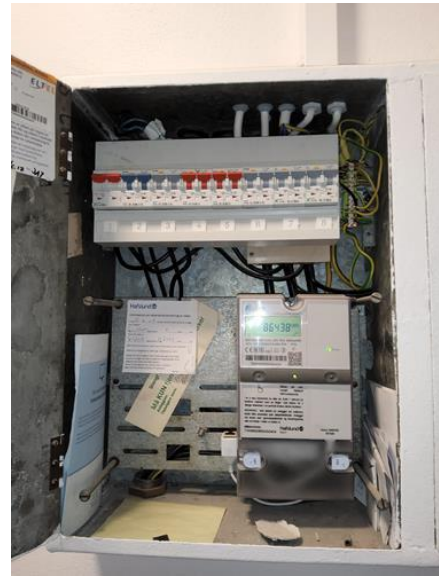
Elektrisk anlegg - [Sikringskap]
