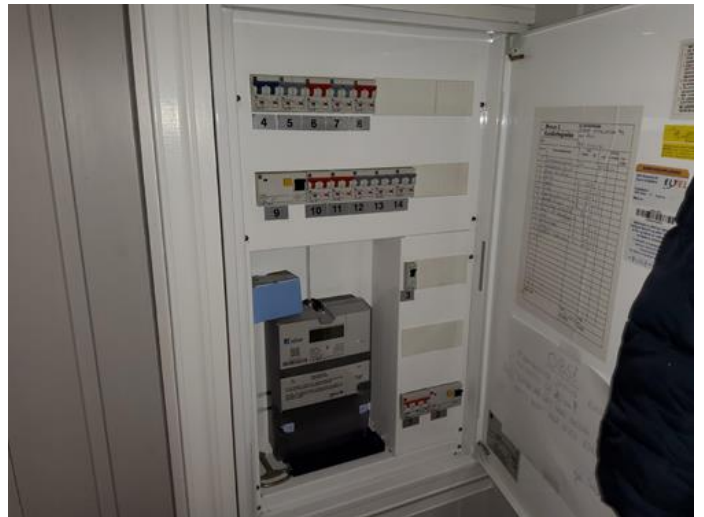
Elektrisk anlegg - [Sikringsskap 8 A.]
