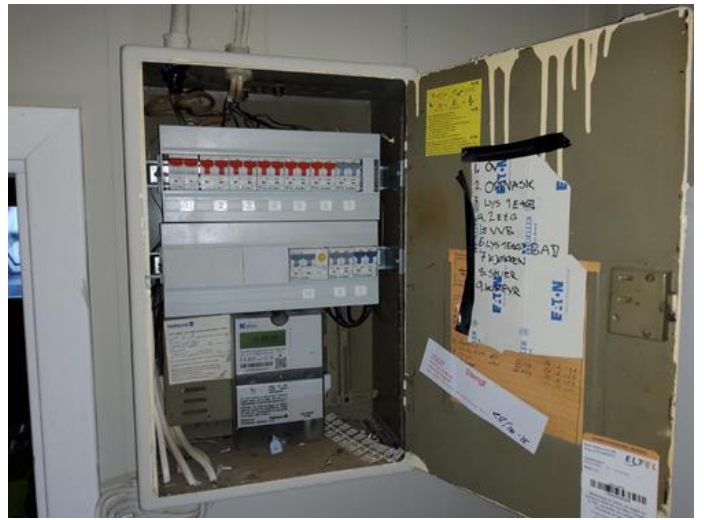
Elektrisk anlegg - [Sikringsskap 8 B.]
