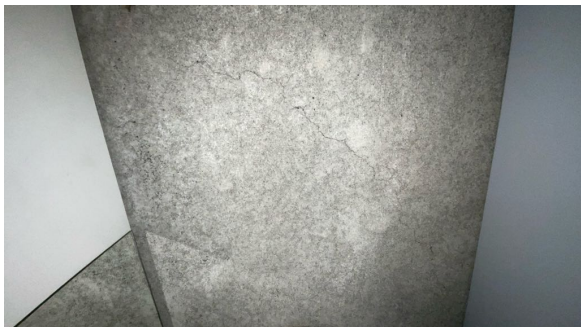
Sprekker i grunnmur
