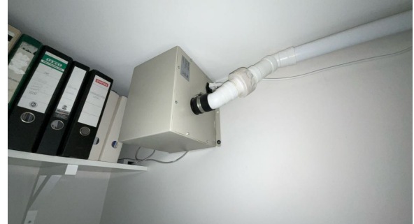
Avsug plassert i kontor
