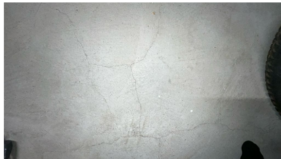
Sprekker i dekket (garasje)
