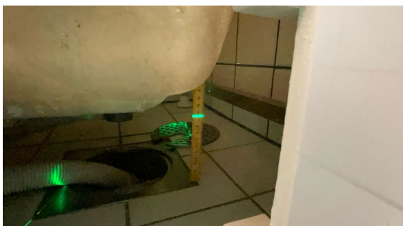
Høydeforskjell (ved sluk)
