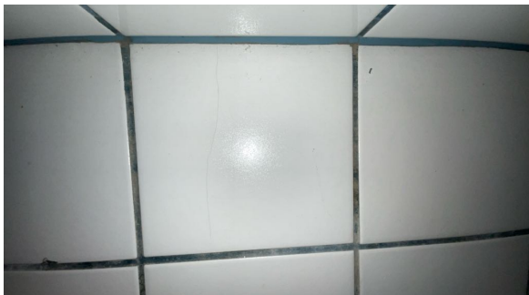
Sprekker i fliser
