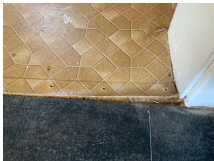
Løse kanter på belegg
