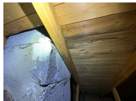
spor av tidligere fukt i himling
