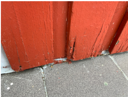
Kledning med oppsprekking og begynnende råte.
