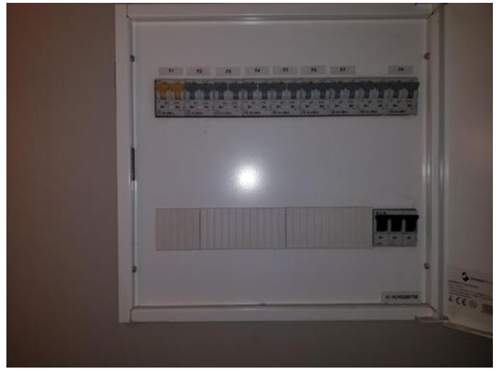
Elektrisk anlegg - [Sikringskap. ]
