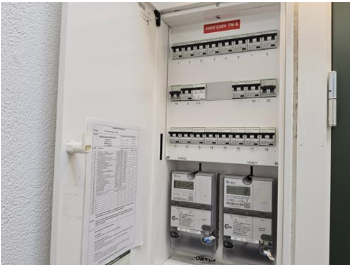
Elektrisk anlegg - [El-skap]
