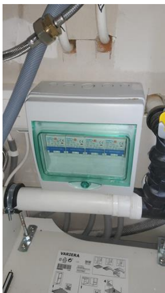
Elektrisk anlegg - [Sikringsskap kjøkken]
