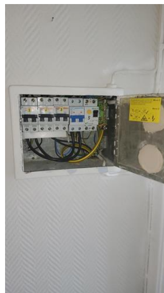
Elektrisk anlegg - [Sikringsskap]
