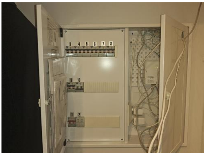
Elektrisk anlegg - [Sikringsskap. ]
