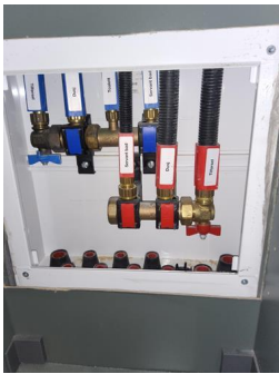
Fordelerskap og fordelerstammer - Fordelerskap
