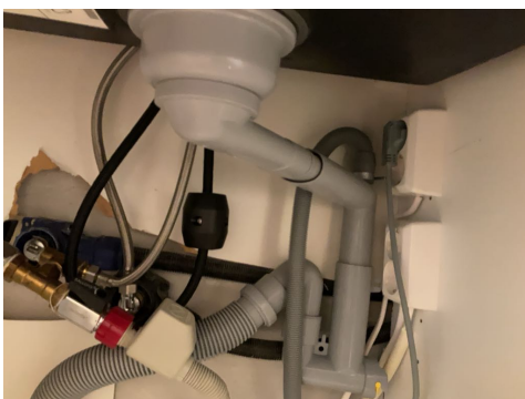
Avløp vask kjøkken
