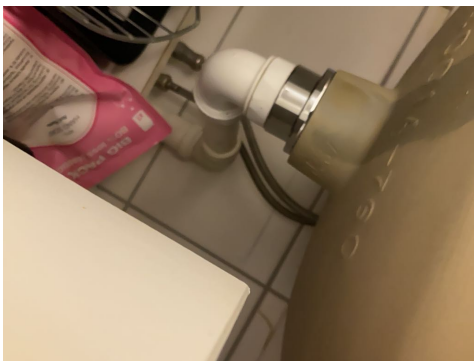
Avløp servant bad
