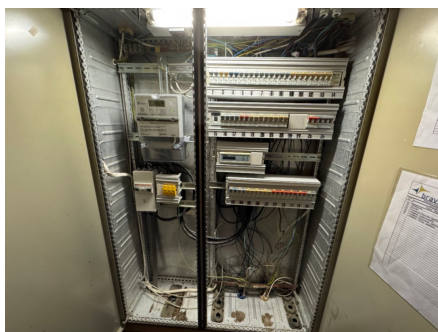
Løse ledninger og åpne koblinger
