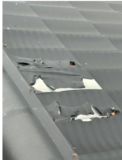
Synlig slitasje. Belegg på takplater flasser av.
