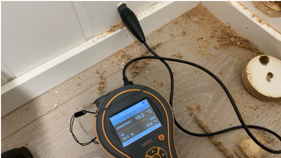
Måling av relativ luftfuktighet i lukket trekonstruksjon mot våtsone fra gang i underetasje.
