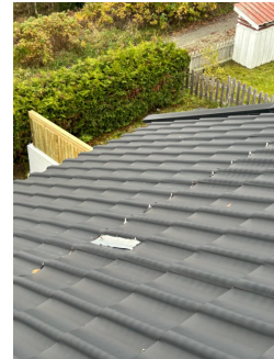
Synlig slitasje. Belegg på takplater flasser av.
