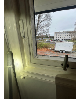
Vindu i bad med slitasje og manglende vedlikehold.
