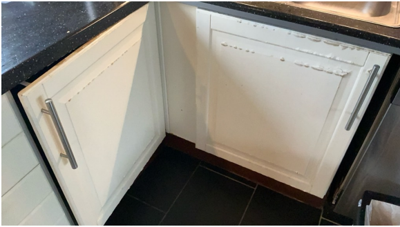
Overflater med ster slitasje.
