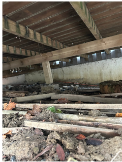
Skjevheter på fundamenter under terrasse
