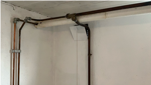
Klaffventil i vaskerom.
