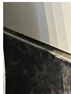
Manglende silikonfuge mellom bunnlist og veggplate.
