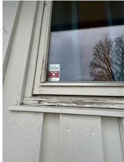
Vindu med utvendig slitasje og angående vedlikehold.
