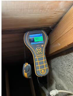
Måling av trefukt med pigg ved pipe.
