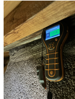
Måling av trefukt med pigg ved pipe.
