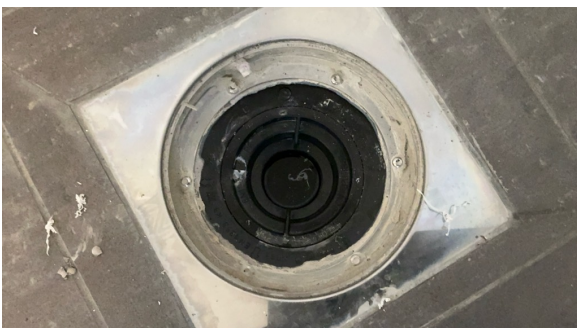
Sluk i vaskerom.
