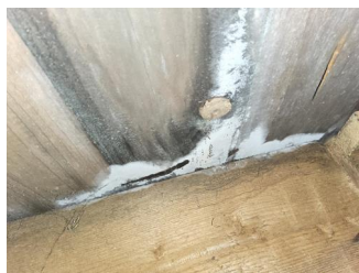
Synlige overflater (taktro, vegger, gulv, o.l.) - Fuktmerker undertak
