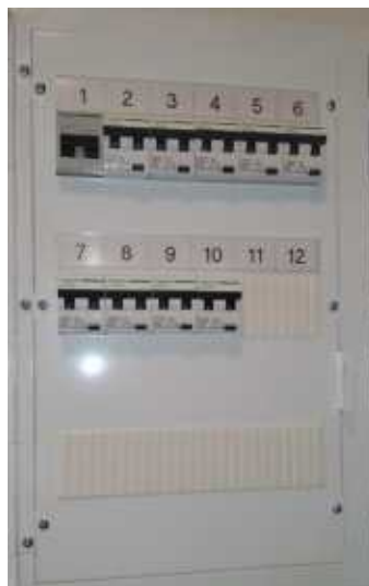
Elektrisk anlegg - [Sikringsskap]
