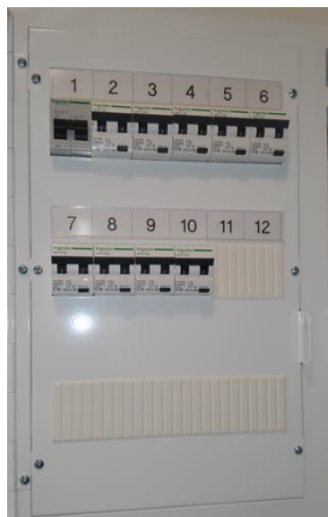
Elektrisk anlegg - [Sikringsskap]
