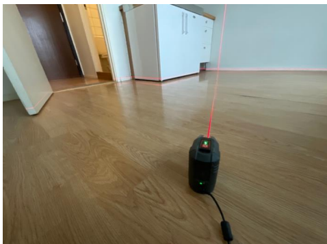
Nivellering stue/kjøkken, avvik ca. 10-20 mm
