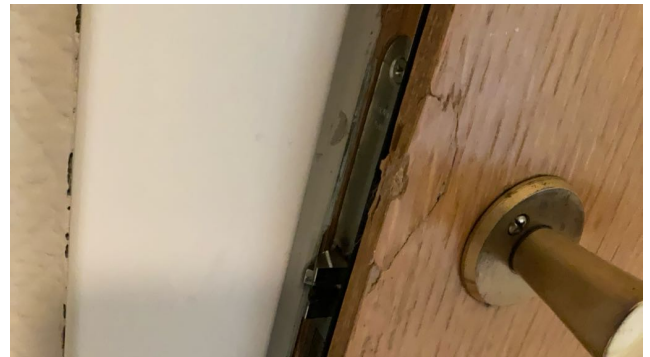
Skade på dørblad
