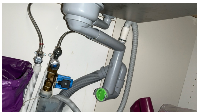
Avløp vask kjøkken
