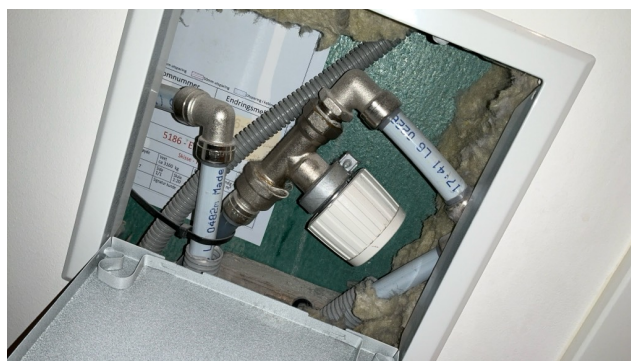
Termostat vannbåren gulvvarme bad. Bak luke i vegg ved bad.
