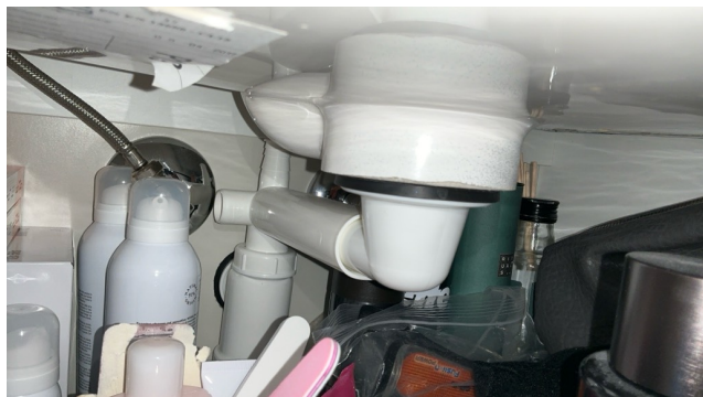
Avløp servant bad
