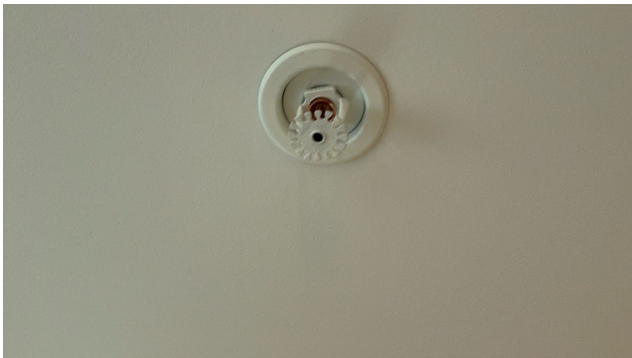
Sprinkleranlegg i tak
