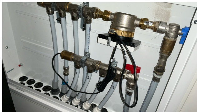
Fordelerskap varme i bodrom
