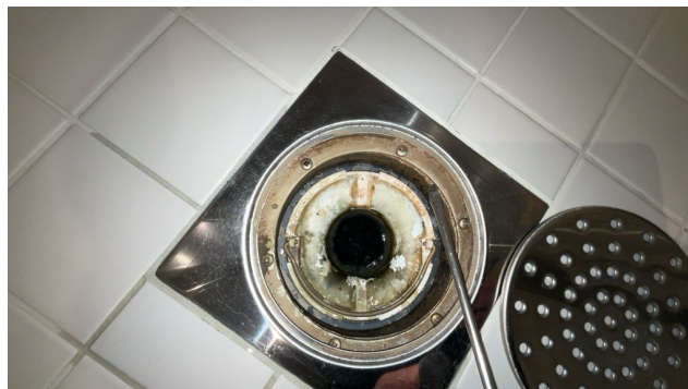
Plastsluk i gulv.
