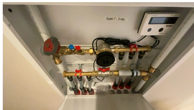
Fordelerskapet til vannbåren varme.
