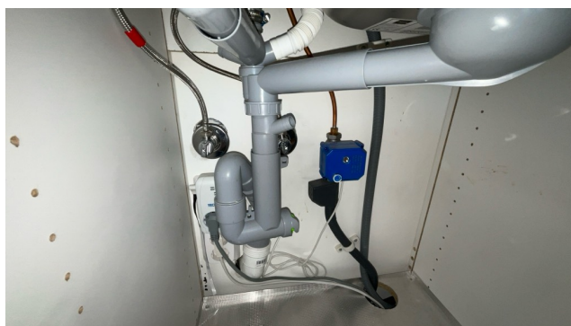
Synlige rør under kjøkkenbenken.
