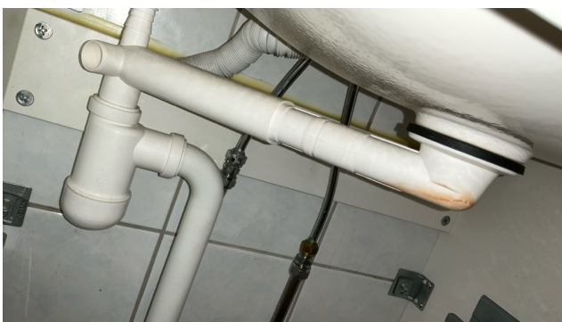
Avløp vask kjøkken
