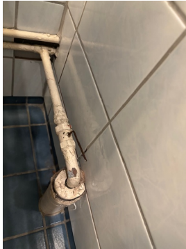
Hovedstoppekran på bad. Ved toalett.
