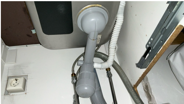
Avløp vask kjøkken
