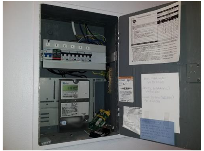
Elektrisk anlegg - [Sikringskap]
