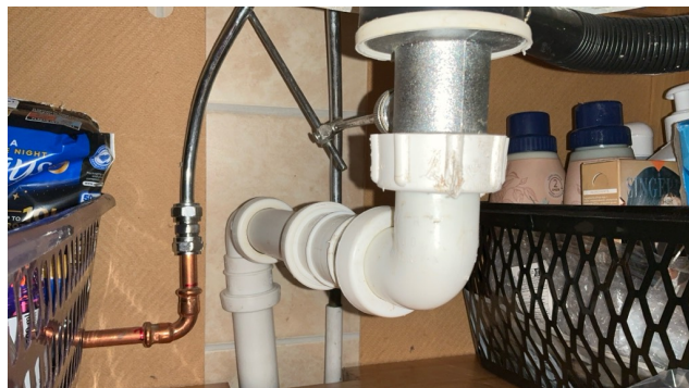
Avløp servant bad
