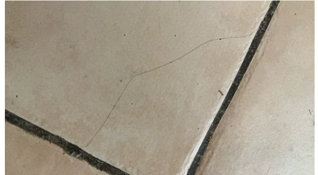
Sprekk i flis entre
