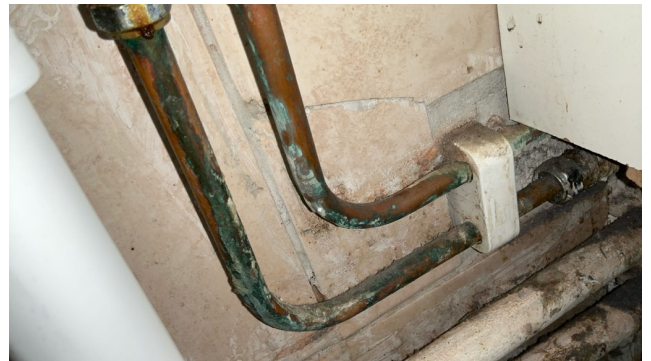
En del irr på vannrør servantskap toalettrom
