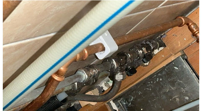
Stoppekraner bad og toalettrom. Ikke tilgjengelig for kontroll.
