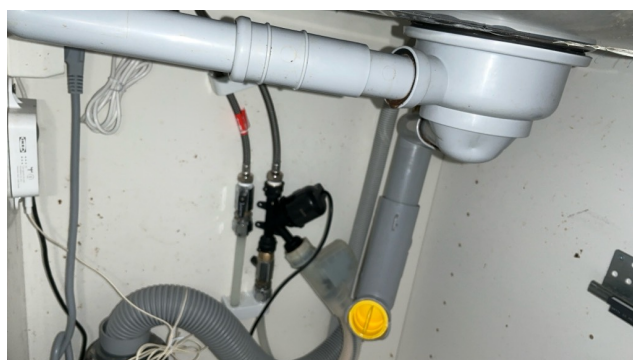
Avløp vask kjøkken
