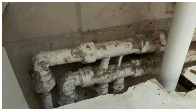
Opprinnelige vannrør. Ikke i bruk. Bilde fra servantskap toalettrom.
