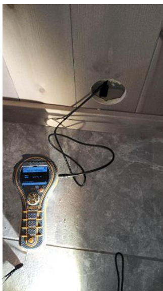
Fukt i tilliggende konstruksjoner - [Fuktmåling bad]
