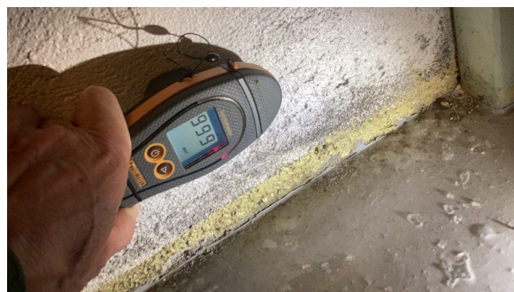
Ved enkle fuktsøk ble det registrert områder med forhøyede verdier.
